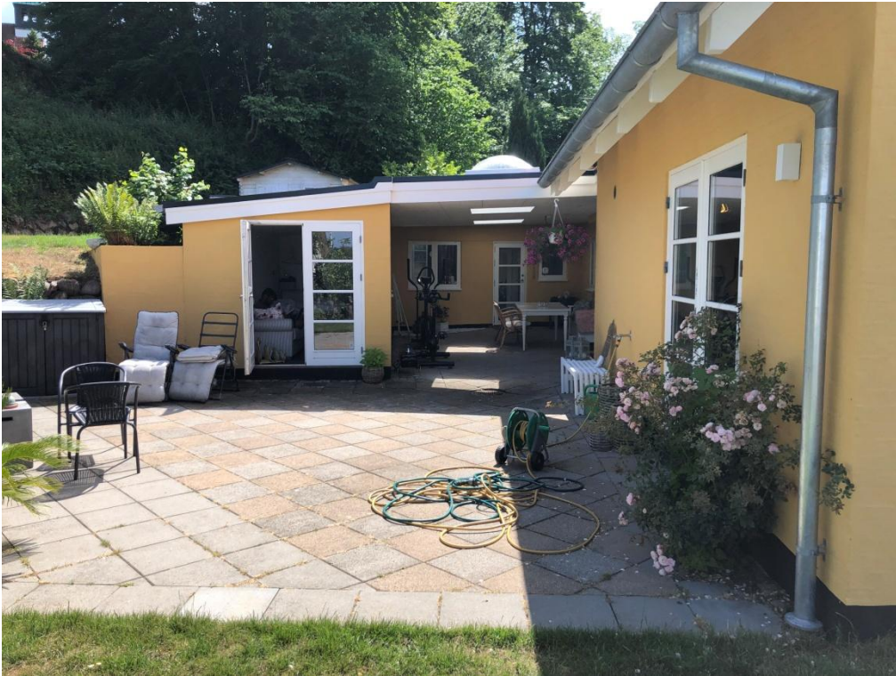
Overdækket areal B over gården mellem bygn. 1 og 2 – med ovenlys – samt bygn. 2 (anneks) til venstre
